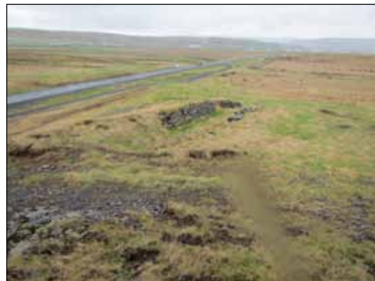
Grjóthleðslurnar í veggjum Vörðuáshússins hafa verið vel hlaðnar en eru teknar að síga nokkuð. Einnig er komið rof í norðurhorn hennar sem sennilega stafar af efnistöku. Horft til austurs.
